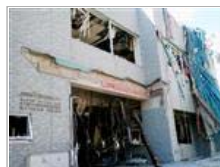
女川原発の緊急拠点に壊滅的被害
